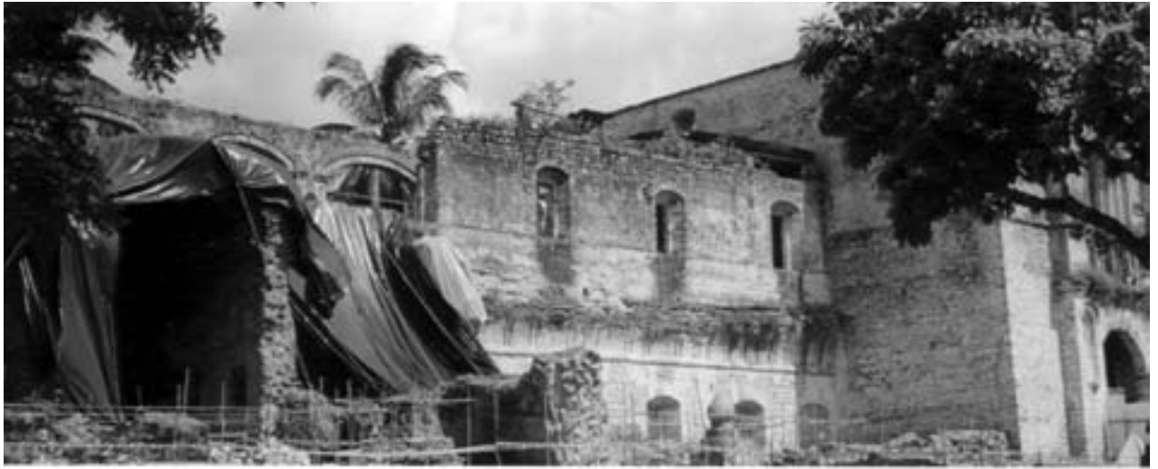
Ex convento. Parte colapsada en el sismo de 1997. Fotografía de la autora, 2002.
