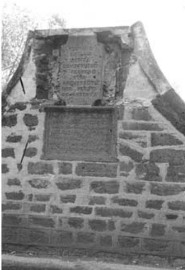
Figura 2. Cartelera en el muro sur del puente, con lechadas de construcción. Foto: G. Bolts, 2004.
