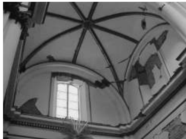
Figura 4. Detalle de daños provocados por el sismo en cubiertas y muros del inmueble, 2003. Archivo de la SMH-Centro INAH Colima, exp. Templo del Sagrado Corazón, Sismo 2003.
