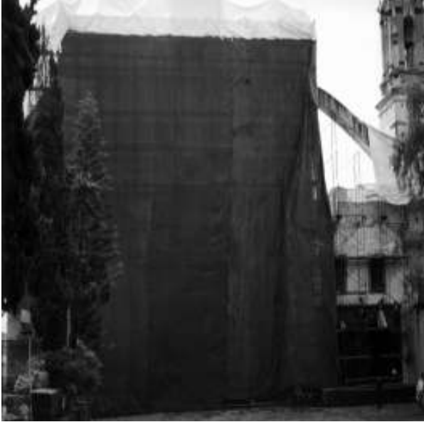
Figura 6. Trabajos de restauración en la fachada principal y capilla de indios del antiguo convento de San Bernardino de Siena. Fotografía de Araceli Peralta F., 2005
