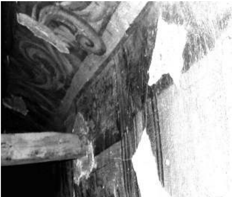
Fotografía 11. Daño ocasionado por el empotramiento del retablo.
