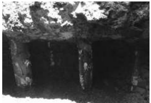
Figura 14. Muro y cara sur de la acequia de La Merced, detalle del pilotaje y mampostería.
