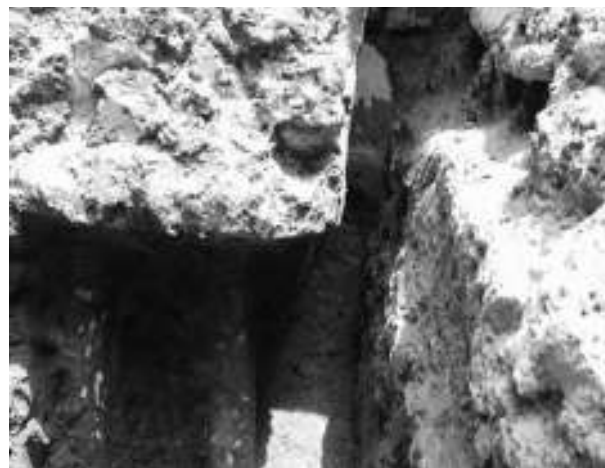
Figura 16. Detalles del muro sur de la acequia de La Merced; arriba se observa la zona alterada para entroncar la atarjea; a la derecha se observa un tramo de la misma atarjea que desaguaba en la acequia; abajo, detalle del pilotaje bajo un basamento junto a la atarjea.
