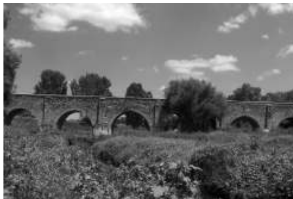
Figura 1. Vista desde el suroeste del puente de San Ignacio, Aguascalientes. Fotografía de Guillermo Boils Morales, julio de 2006.
