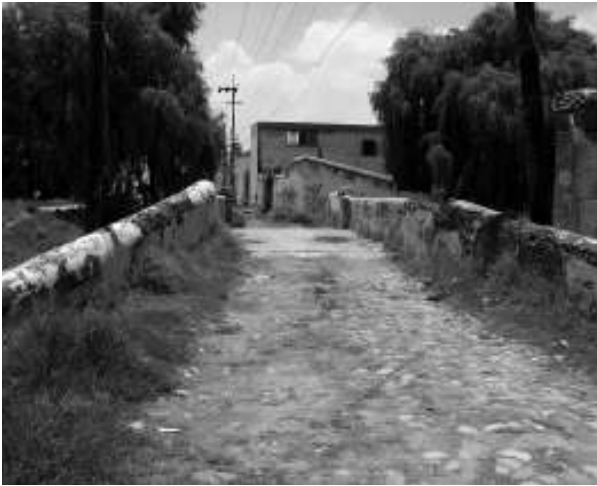
Figura 11. Puente de la hacienda de Atenco, Estado de México, desde el noroeste. Fotografía de Guillermo Boils Morales, julio de 2008.
