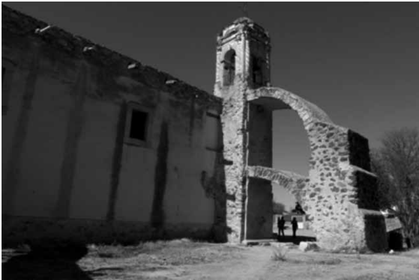
Figura 10. Vista de la torre y arco botarel de la capilla. Fotografía de Alberto Ramírez Ramírez.
