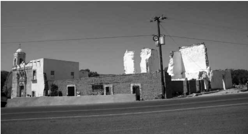
Figura 18. Arquitectura de adobe, proceso de intervención planta baja. Fotografía de Alberto Ramírez Ramírez.
