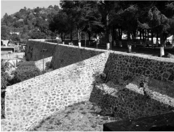
Figura 12. Fachada sur del basamento del conjunto conventual de Tetela del Volcán, en la que se aprecian los muros en escarpe que contienen los rellenos de arcilla. Fotografía de Mario Córdoba Tello.
