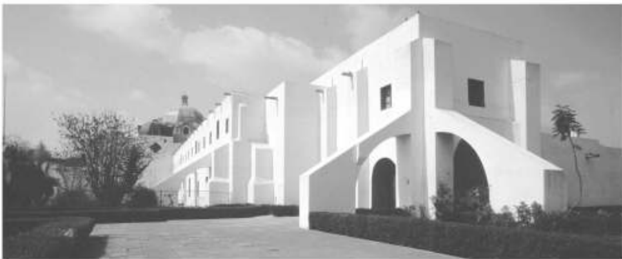
Figura 5. Arbotantes en la parte posterior oriental del convento, edificadas en virtud de la alta sismicidad de la zona.
