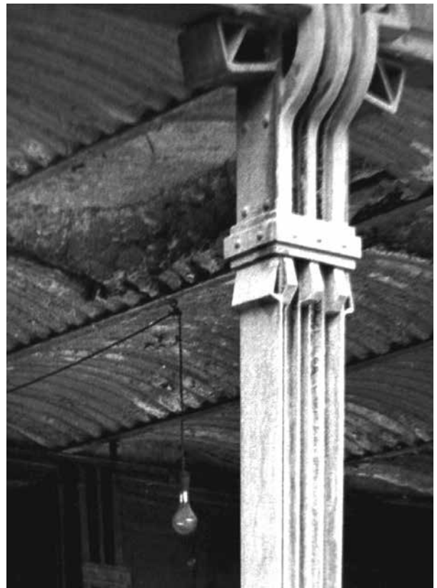
Figura 12. Museo de la calle del Chopo. Armado por los ingenieros Bacmeister y Ruelas, México, 1910. Israel Katzman, Arquitectura del siglo XIX en México , México, Trillas, 1993.
