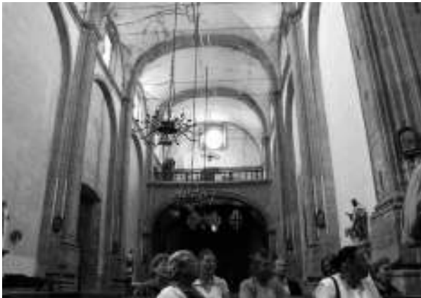
Figura 1. Interior de la iglesia de la Santísima Trinidad antes de su restauración, donde muestra la bóveda fracturada. En primer plano aparecen algunos de los cofrades de Nuestra Señora del Perpetuo Socorro. Fotografía de Nuria Salazar Simarro, 31 de marzo de 2009.
