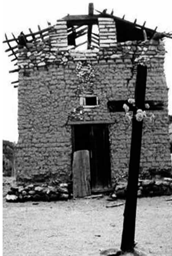
Figura 6. Presento esta iglesia de fábrica jesuita con la finalidad de dar idea del aspecto físico en que pudo estar la obra material a la entrega a la orden franciscana; se pueden distinguir diferentes deterioros provocados por la falta de protección superior, inferior y de todos los muros que incluso ya ocasionaron un fuerte debilitamiento de éstos, además de provocar grietas superiores y socavar en la parte inferior del muro, a pesar de la primitiva protección a base de piedras. Iglesia de San Antonio Guazarachi, Chihuahua. Misiones Coloniales de Chihuahua.
