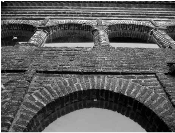
Figura 7. Colonias de hongos se han apoderado de algunos sectores de los lienzos del claustro mudéjar de Santa María de Tentudía en Calera de León, Badajoz, como resultado de la eliminación de los revocos encañados que protegían sus muros. Fotografía de Pilar Mogollón.
