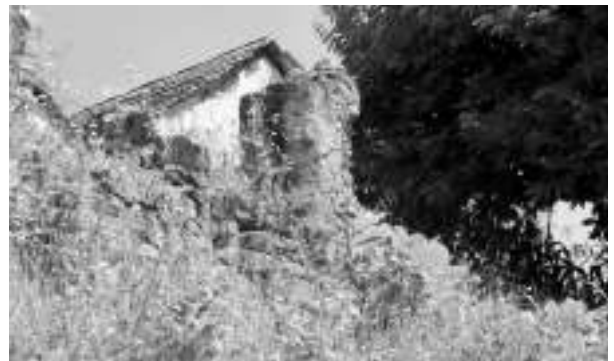
Figura 6. Vestigios de una probable compuerta y del muro de contención de la plataforma del convento.
