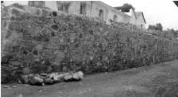
Figura 13. Basamento sobre el que se desplantó el conjunto conventual de Santo Domingo de Guzmán Hueyapan.
