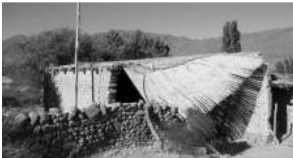
Figura 9. Techo colapsado de una casa de la Finca Potrero que muestra la cubierta de carrizos.
