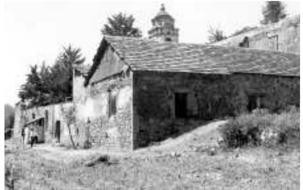
Figura 4. Sur del claustro de Santo Domingo, utilizado como parcela agrícola. La tierra acumulada en esta sección está ocasionando problemas de humedad en las habitaciones del claustro.
