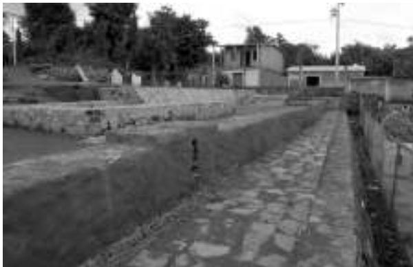
Figura 12. Muro de contención y delimitación de la terraza sur del convento y del área de la huerta. En segundo plano se aprecia el canaleta intramuro, con una de las salidas que drenaban hacia la huerta.
