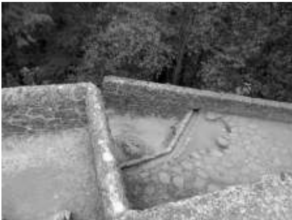
Figura 6. Ermita de San Elías. Cañería de desagüe a la barranca. Fotografía de Virginia Guzmán, 2013.
