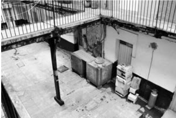
Figura 15. Polín que da soporte al dañado sistema de andadores. Fotografía de Patricia Viridiana Sánchez Ramírez, 2017.
