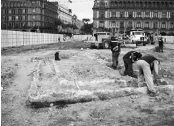
Figura 20. Limpieza de brocales de concreto armado relacionados con los trabajos de la cancelada Línea 8 del Metro, registrados en el sector suroeste de la plaza durante los trabajos arqueológicos de 2017. Fotografía de Alejandro Meraz Moreno, Gonzalo Emilio Díaz Pérez, Rubén Arroyo Ángeles y Ricardo Castellanos Dounce, op. cit.
