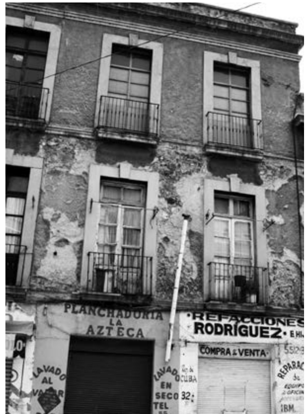
Figura 14. Daños en la fachada. Fotografía de Patricia Viridiana Sánchez Ramírez, 2017.
