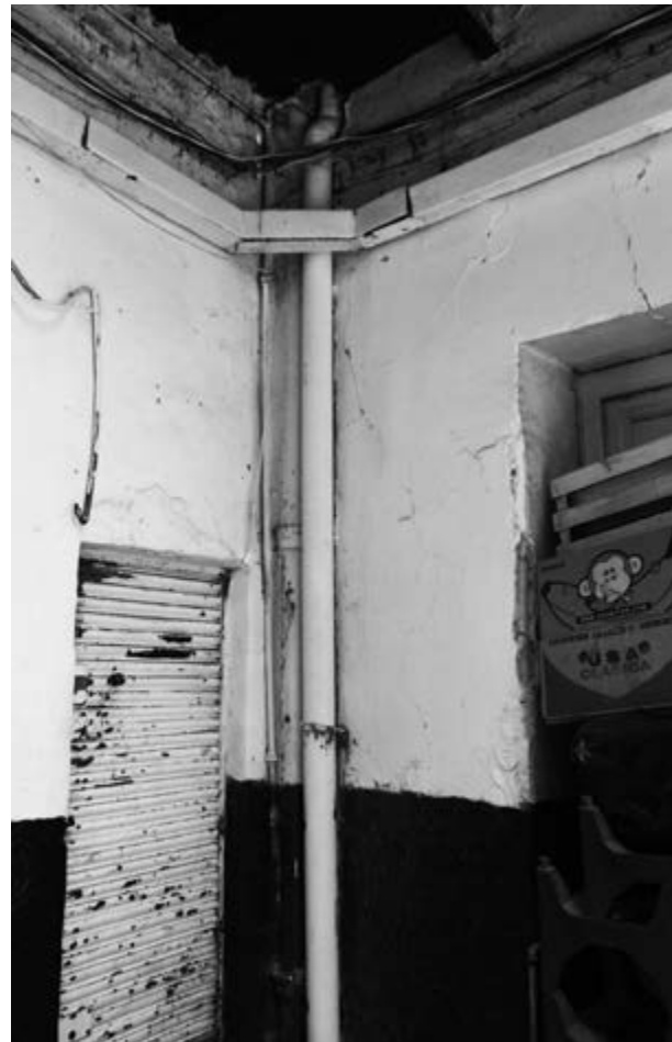
Figura 10. Estado de las instalaciones eléctricas y de desagüe dentro del inmueble. Fotografía de Patricia Viridiana Sánchez Ramírez, 2017.
