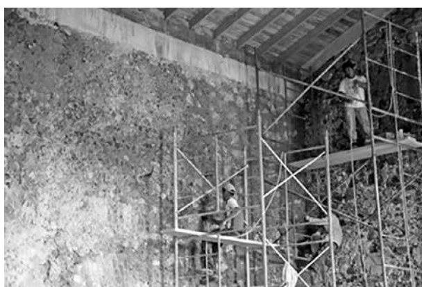
Figura 10. Obras de restauración de la primera etapa: bodegas, consolidación de muros de piedra, 2014. Expediente Técnico, Sección de Monumentos Históricos, Centro INAH Veracruz, 1993.
