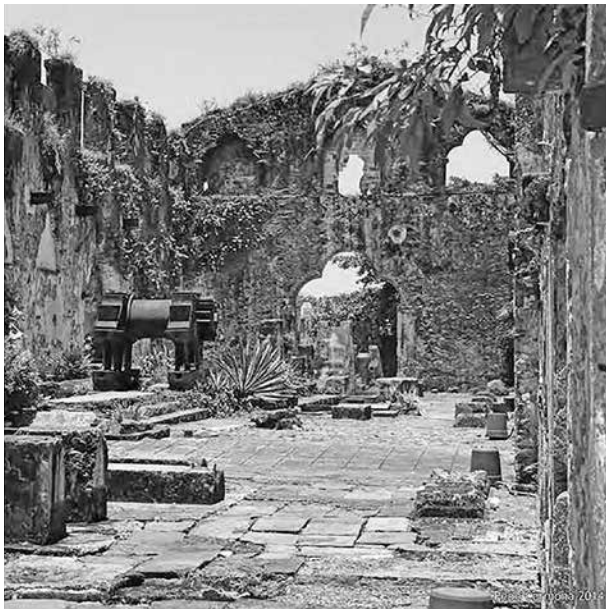
Figura 6. Vista interior de la nave principal, ya destechada. Expediente Técnico, Sección de Monumentos Históricos, Centro INAH Veracruz, 1993.
