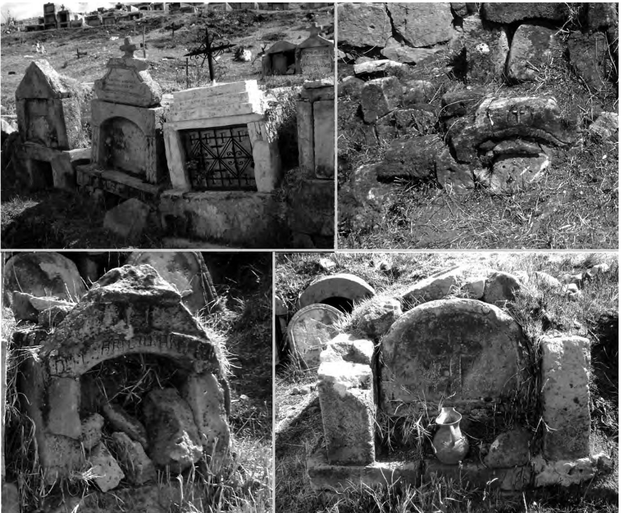
Figura 16. Muestras de deterioro de los elementos líticos: asentamiento diferencial por deficiencia geotécnica, soterramiento, daño mecánico (rotura) y colapso de bóvedas por fatiga de materiales.
