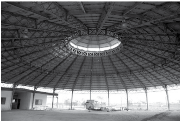
Figura 11. Una vista general del interior de la cubierta actual. Fotografía de Roberta Vassallo.
