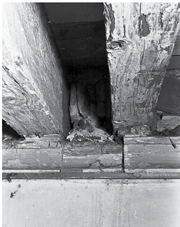
Figura 9. Vigería en uno de los salones de la Escuela. Toda la vigería existente fue retirada y sustituida por concreto armado en 1976. Fotografía del ingeniero Alberto Lepe Zúñiga, 1964, colección del AHFM.
