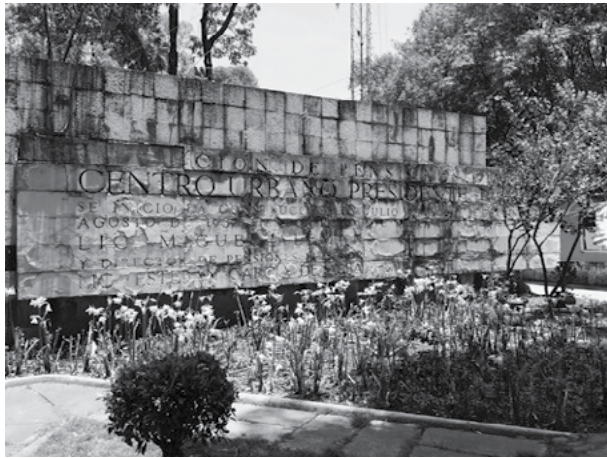
Figura 7. Placa alusiva a la construcción e inauguración del CUPJ; nótese el estado ruinoso de conservación que amenaza su permanencia. Fotografía de Pablo Francisco Gómez Porter, 2015.
