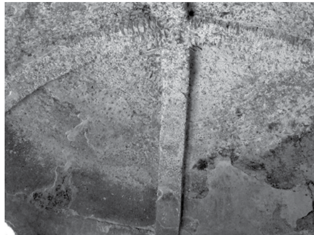
28. Arcos fajones diagonales y aparejo recto de la cubierta de la noria del ex convento de La Asunción en Mama, Yucatán. Fotografía de Manuel Arturo Román Kalisch.
