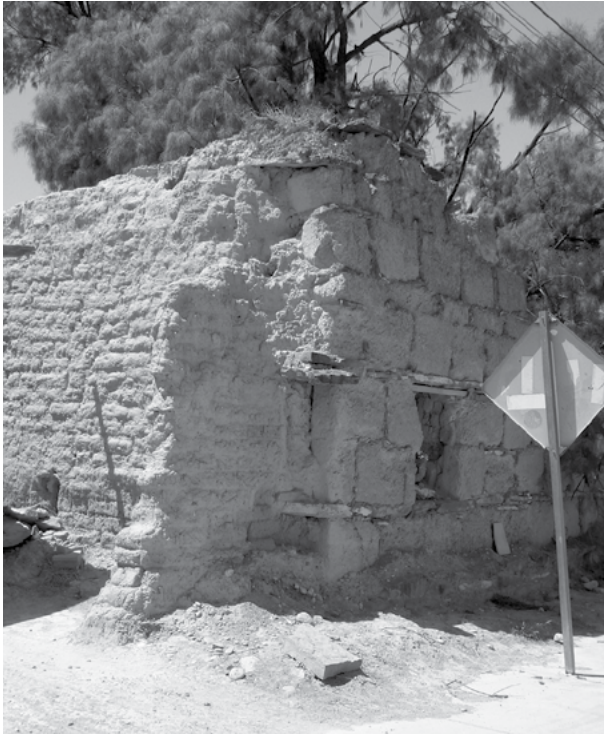
Figura 4. Aspecto constructivo de muro en Villa del Progreso, Coahuila. En las nuevas poblaciones el imperativo de construir con materiales del lugar provocó que intentaran resolverse problemas con los medios disponibles. En la imagen se aprecia el refuerzo de un muro de adobe empleando lajas y recubrimiento de sillar de cantera. Fotografía de Alejandro González Milea, 2008.
