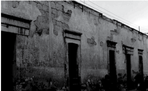
Figura 3. Aspecto de la antigua Casa Márquez en estado de abandono. Fotografía de Alejandro Acosta Collazo, febrero de 1997.
