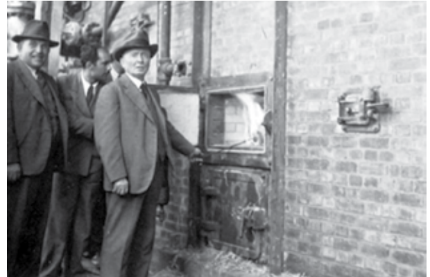
Figura 18. Alberto Lenz Adolph enciende por vez primera la hoguera de la caldera de la Fábrica de Celulosa. Véase la cantidad de paja que hay en el piso. Colección Alberto Lenz Krahl.
