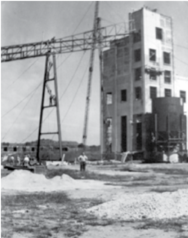
Figura 13. La grúa está por colocar el resto de la banda transportadora. En uno de los soportes en forma de triángulo de la banda se aprecian unas ingeniosas y peligrosas escaleras para los obreros. Colección Alberto Lenz Krahl.
