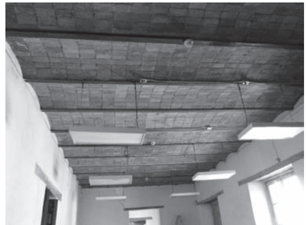
Figura 14. Los techos de vigueta y bovedilla presentes en muchos espacios del inmueble; con los trabajos de 2009-2014 se han cubierto con argamasa blanca los ladrillos, sin razones históricas reales. Fotografía de Elsa Hernández Pons.
