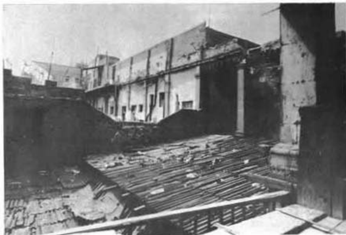
Aspecto que presentaba el claustro antes de los trabajos de restauración y reconstrucción.
