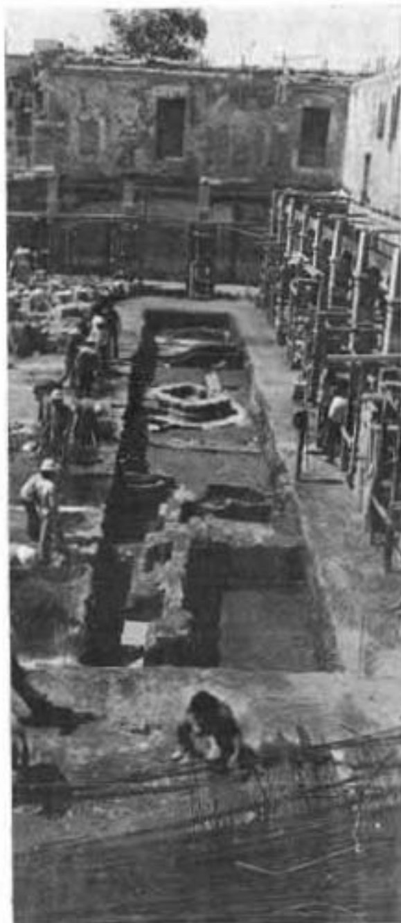
Trabajos arqueológicos en el sector Este del claustro, durante la segunda temporada de excavaciones.
