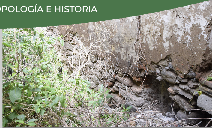
Imagen 12. Los pisos se encontraban cubiertos de escombros, basura y vegetación
