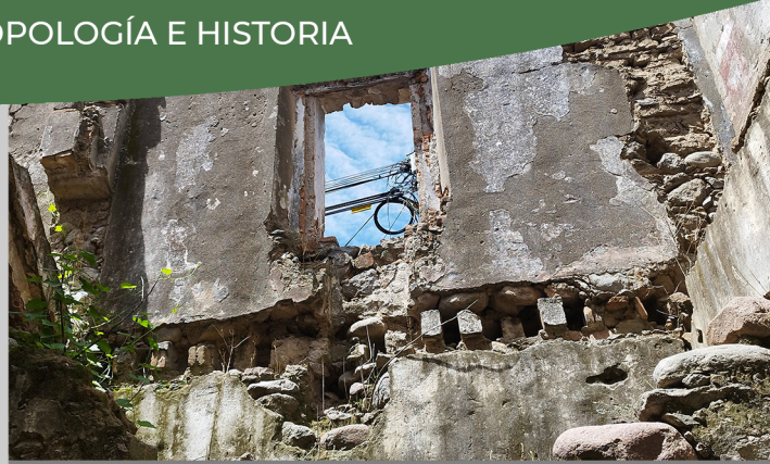
Imagen 8. Vista de los daños y deterioros en la tercera cruzía, planta baja y primer nivel
