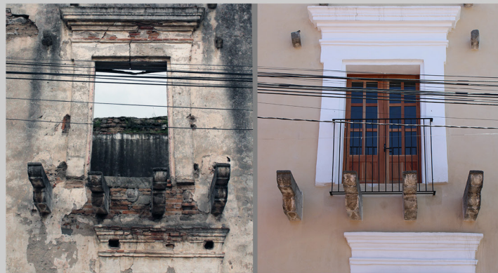
Imagen 21. Deterioro que presentaban los balcones en la fachada lateral oeste
