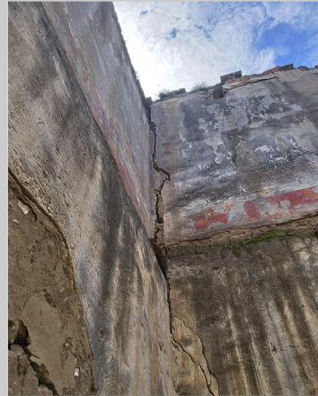
Imagen 13. Grietas en las uniones de los muros
