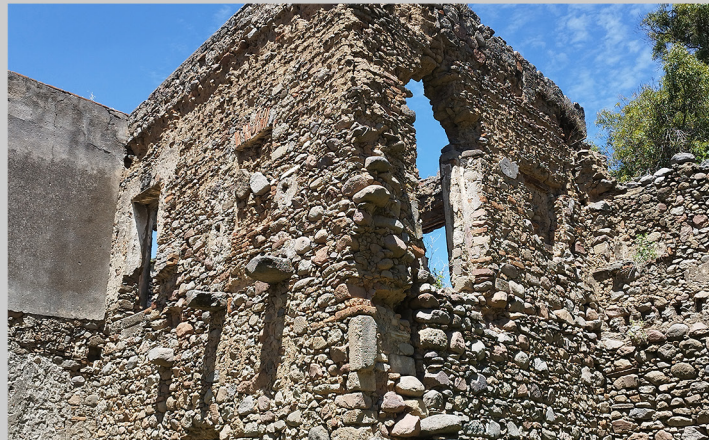
Imagen 9: Vista desde el interior, se aprecia la total pérdida de aplanados y la disgregación de la mampostería
