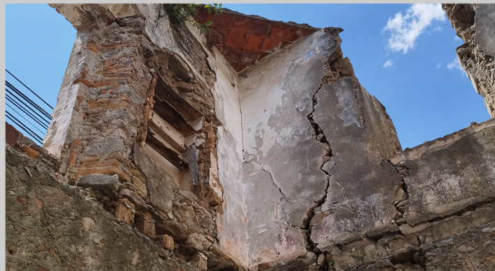
Imagen 10. Vista de fractura en muro, lado noroeste del inmueble
