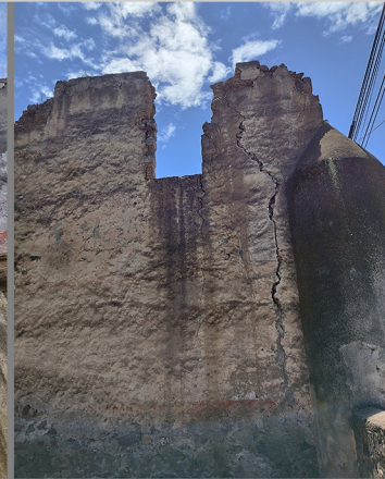
Imagen 15. Fractura en muro, lado norte
