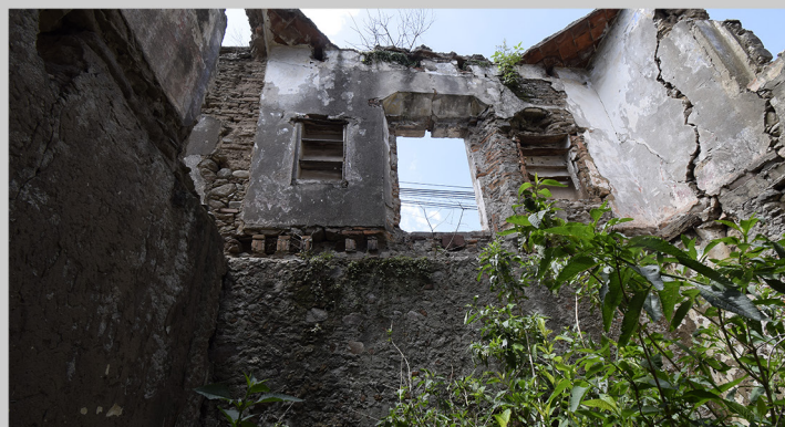
Imagen 11. Vista desde el interior, lado noroeste, donde el paso es prácticamente imposible por la gran cantidad de flora
