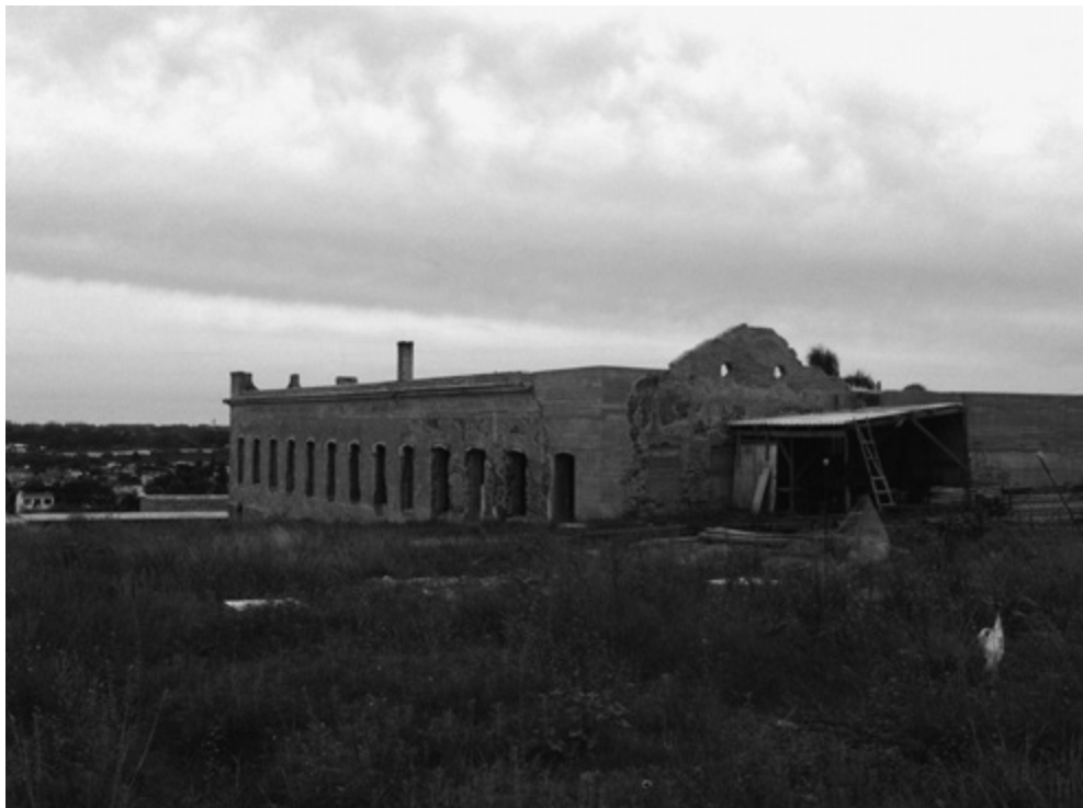
Figura 7. Enfermaria de Jaguarão aparecendo a ruína preservada e parte da cortina de concreto armado. Imagen do autor.
