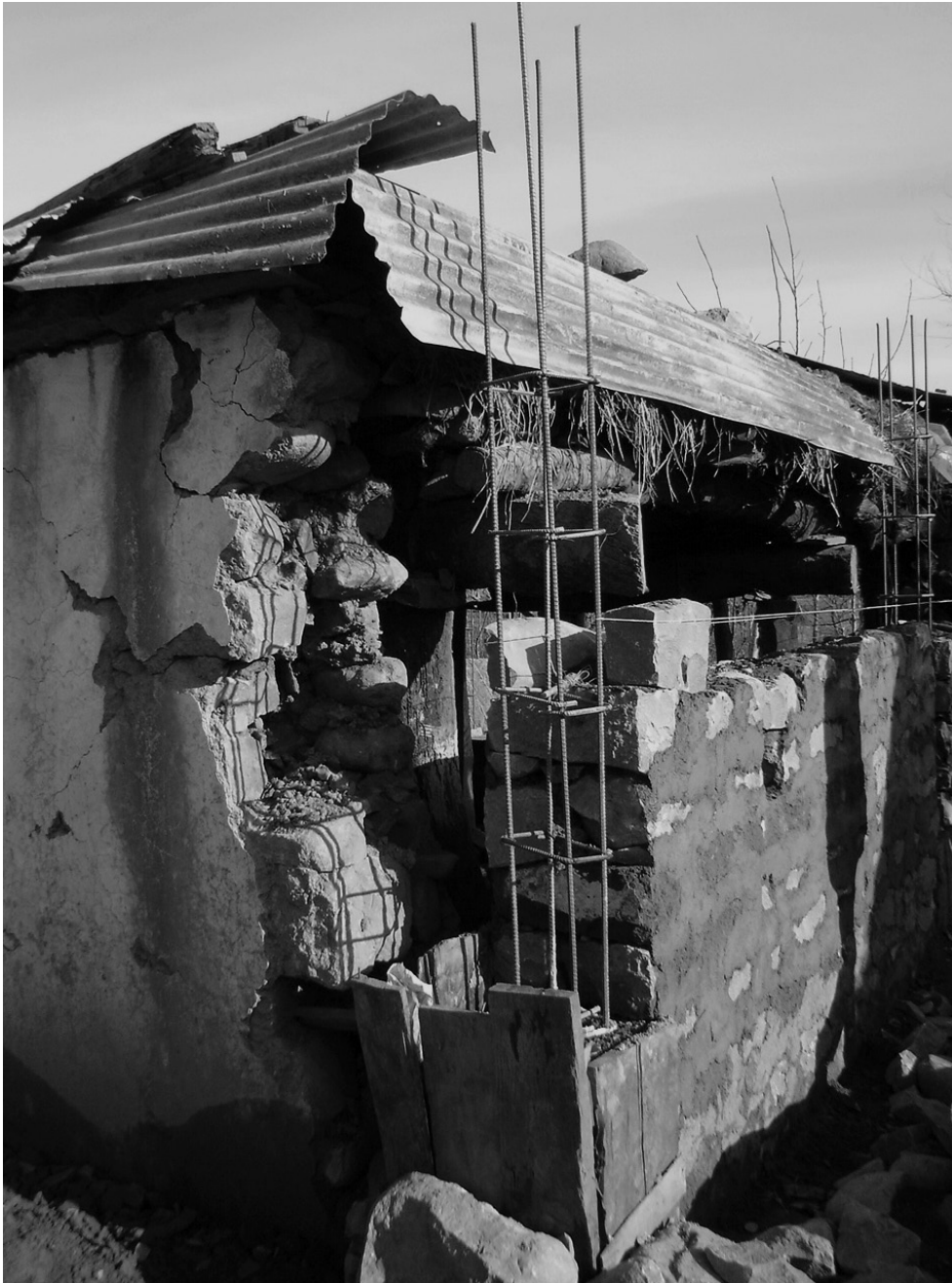
MARATHWADA, INDIA. Los albañiles locales llevan a cabo prácticas de construcción inseguras, utilizando nuevos materiales y tecnología por falta de conocimientos apropiados y por los costos relacionados. Imagen: Rohit Jigyasu.
