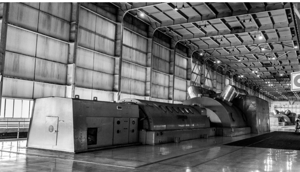
FIGURA 5. INTERIOR DE LA NAVE DE TURBINAS DE LA UNIDAD DE PRODUCCIÓN TÉRMICA TERUEL (ANDORRA), 1979-2020. Imagen: Carlos Colás.
