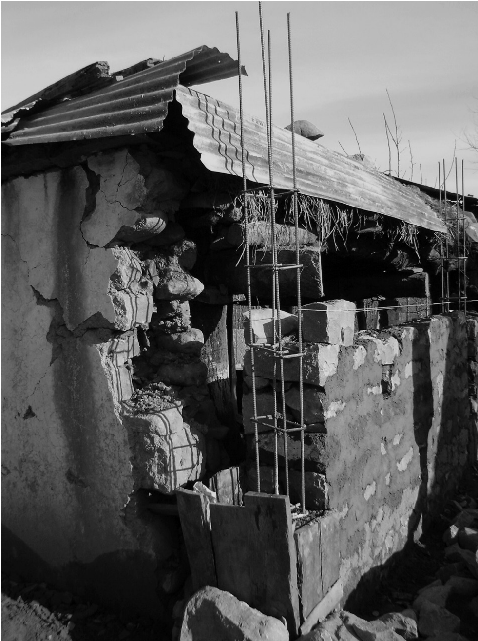
MARATHWADA, INDIA. Los albañiles locales llevan a cabo prácticas de construcción inseguras, utilizando nuevos materiales y tecnología por falta de conocimientos apropiados y por los costos relacionados. Imagen: Rohit Jigyasu.
