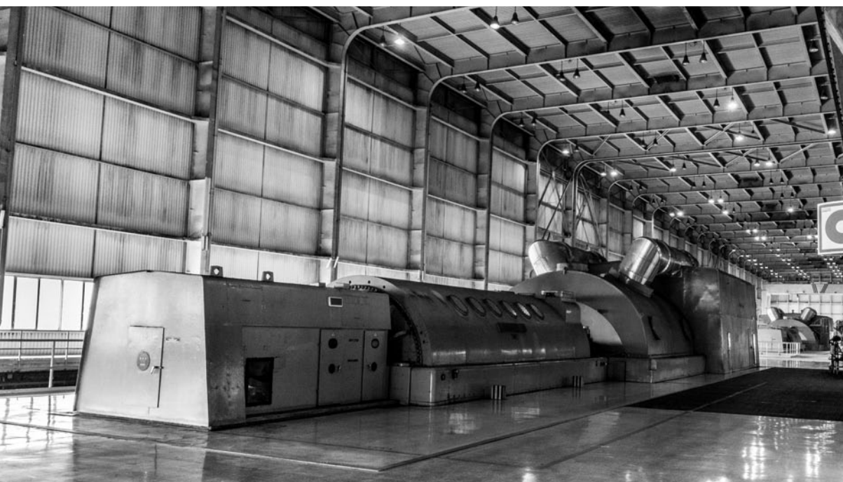
FIGURA 5. INTERIOR DE LA NAVE DE TURBINAS DE LA UNIDAD DE PRODUCCIÓN TÉRMICA TERUEL (ANDORRA), 1979-2020. Imagen: Carlos Colás.
