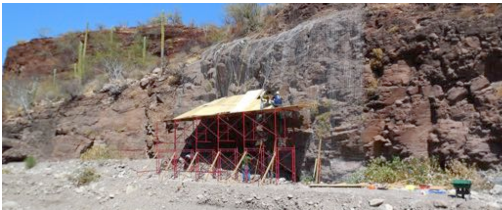
Figura 5. Colocación de protección previa a los trabajos de liberación del abrigo con pinturas rupestres. Imagen: Sandra Cruz Flores, ©CNCPC-INAH, 2016.
