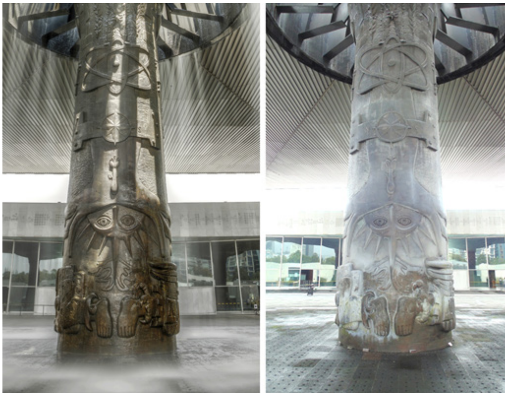
Figura 1. Comparación del acabado del relieve escultórico. Izquierda - Recubrimiento recién aplicado. Derecha - Recubrimiento deteriorado. Imágenes: Armando Arciniega, ©CNCPC-INAH, 2016.
