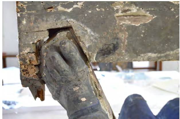
▲ Figura 3 Detalle de deterioro por ataque de insecto xilófago.
