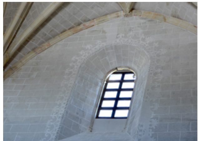
▲ Vista de una de las nueve ventanas con el diseño floral recuperado después del desencalado. | Foto: © Acervo CNCPC-INAH, 2016.
