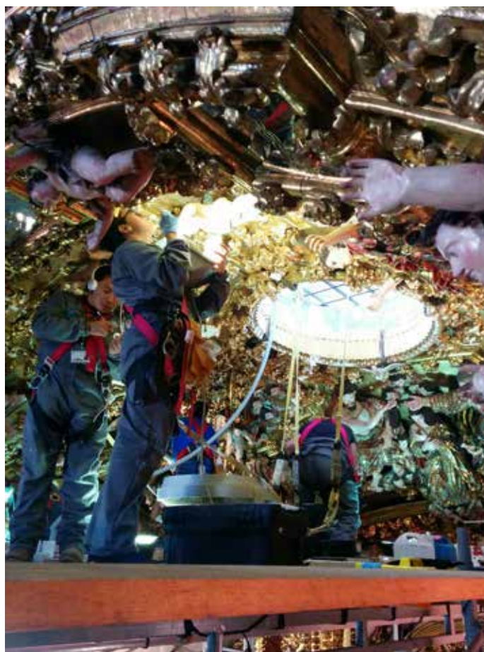
▲ Proceso de resane en la bóveda del retablo de la Virgen de Ocotlán. Centro INAH Tlaxcala | © INAH, 2014.
