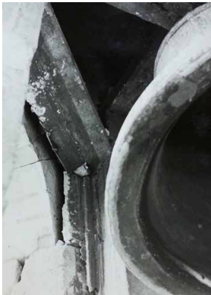
▲ Fig. 9 Estructura interior de refuerzo. (ACNMH. Exp. San Juan Bautista de Coixtlahuaca. Leg. 2. Foto n° 25a). | © INAH, 1980.
