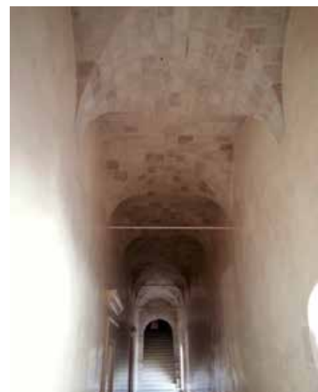
▲ Fig. 27 Interior del pasillo junto a la escalera principal, 2014. Fototeca CNCPC | © INAH, 2014.
