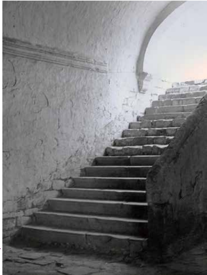
Fig. 33 Escalera de acceso a planta alta antes de la restauración. COIXTLAHUACA_11A-5_1964-1965. X-20-4-5. Enero 1964. Fototeca CNCPC | © INAH, 1964.
