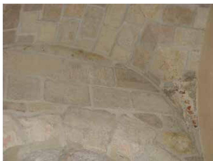
▲ Fig. 31 Restos de una de las bóvedas originales, 2014. Fototeca CNCPC | © INAH, 2014.
