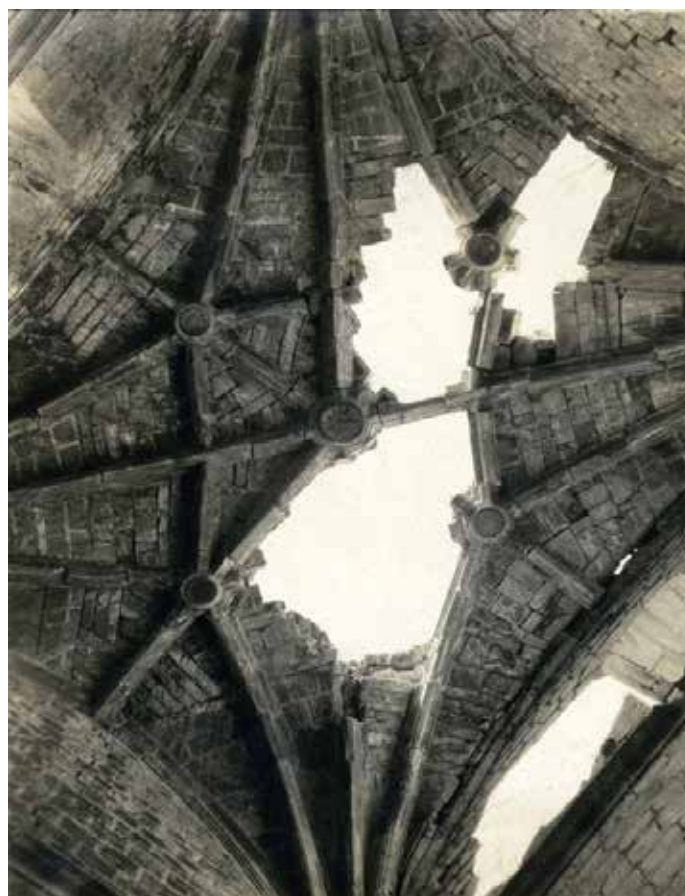
▲ Fig. 3 Estado de la bóveda de la sacristía adyacente a la capilla abierta. sn_folio83. V0A15TVII-B, CNMH | © INAH, 1926.
