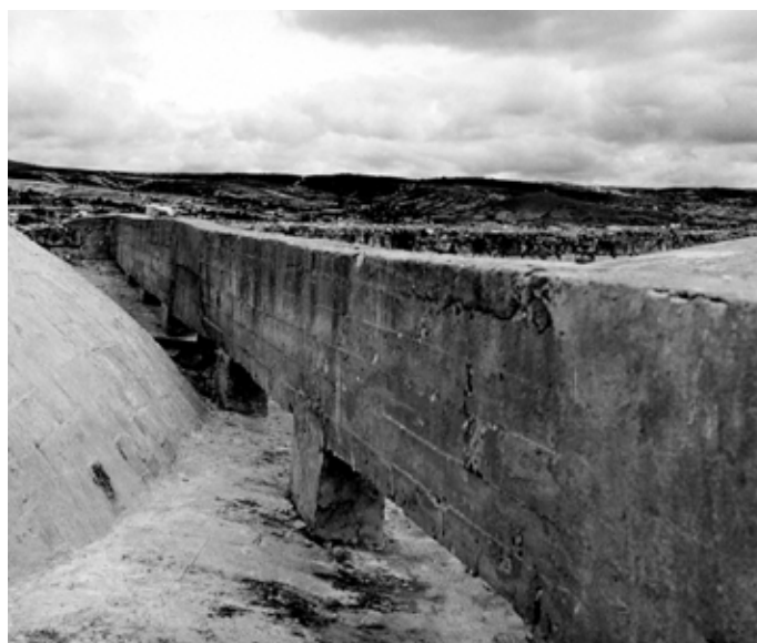
▲ Fig. 18 Zuncho de atado sobre las bóvedas. COIXTLAHUACA_11A-3_1964-1969. XXIII-11-2. F. Palancares. Fototeca CNCPC | © INAH, 1965.
