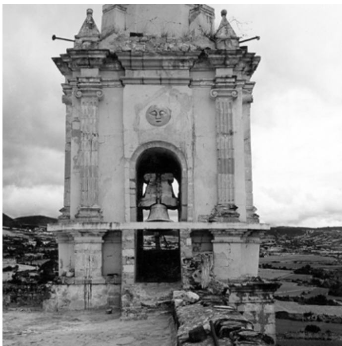
▲ Fig. 12 Torre después de la restauración de 1957. COIXTLAHUACA_11A-3_1964-1969. XXIII-9-2. F. Palancares. Fototeca CNCPC | © INAH, 1965.
