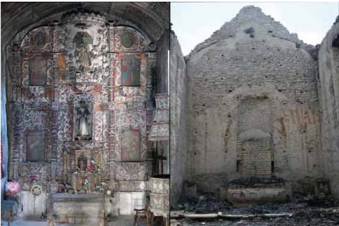
▼ Presbiterio de la iglesia antes y después del incendio | © CNCPC- INAH, 2006 y 2007
