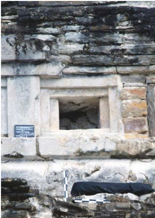
Figura 7. Vista de la cara exterior del nicho donde se aprecia la capa de aplanado. Nicho No. 289, Cuerpo 5, Fachada Sur.
