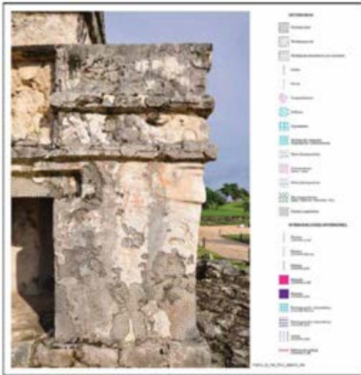
Figura 1. Ejemplo de un registro de deterioro. Pérdida total. Registro: Claudia Trejo Murguía. Imagen: Víctor Gabriel Severiano Flores, ©CNCPC-INAH, 2013.
