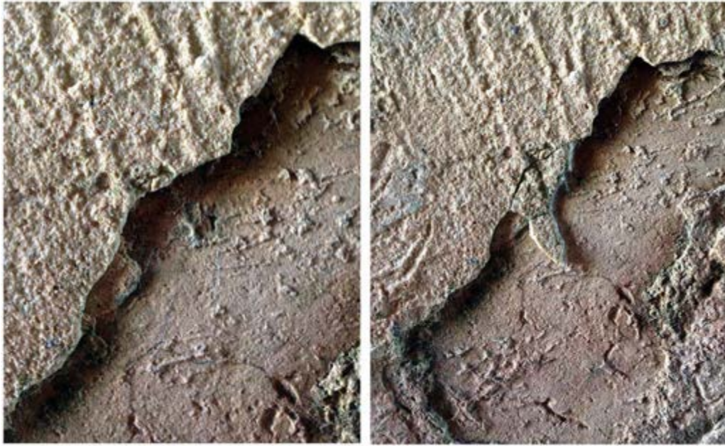
Figura 13. Antes y después de la adhesión de una escama de la pintura mural. Imagen: Mariana Díaz de León, 2016, ©CNCPC-INAH.
