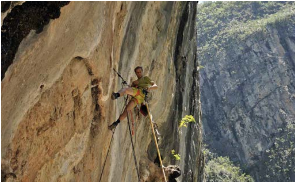
Figura 5. Remoción de elementos metálicos que afectaban la pared con pinturas rupestres. Sitio La Ciénega, Nuevo León. Imagen: Omar Torres Cuervo, 2016, ©CNCPC-INAH.
