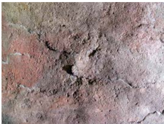
Figura 3. Acercamiento donde se observa la disgregación por escamas y pulverización además de velos blancos por eflorescencia de sales. Puede notarse también la disgregación del aplanado. Imagen: Proyecto de conservación e investigación para las pinturas murales y otros acabados arquitectónicos de la zona arqueológica de Cholula, Puebla, ©CNCPC-INAH.
