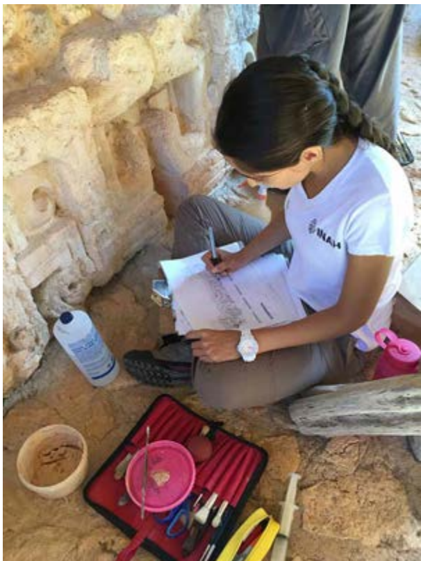
Figura 3. Actividades de registro de deterioro in situ. Imagen: Alejandra Alonso, ©CNCPC-INAH.
