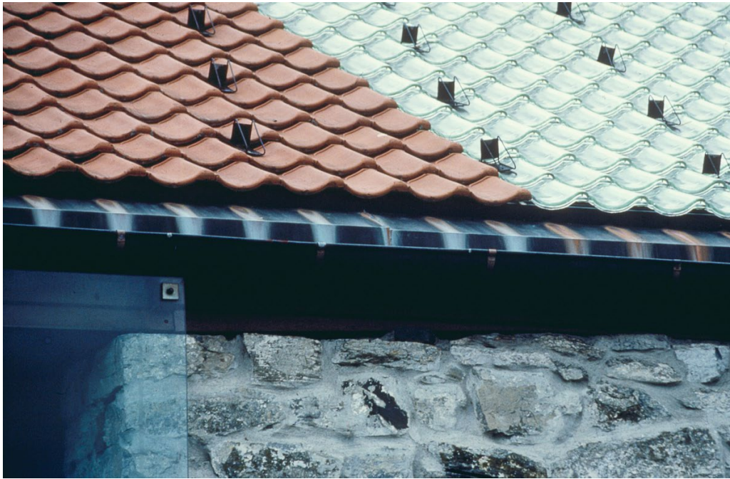
Figura 6. Tejas opacas y tejas traslúcidas, las segundas no cuentan con filtro solar, son lugar de origen de problemas técnicos por la falta de protección contra los rayos UVA. Imagen: ©Nasjonalmuseet Arkitektur Fotoarkive, 2009.
