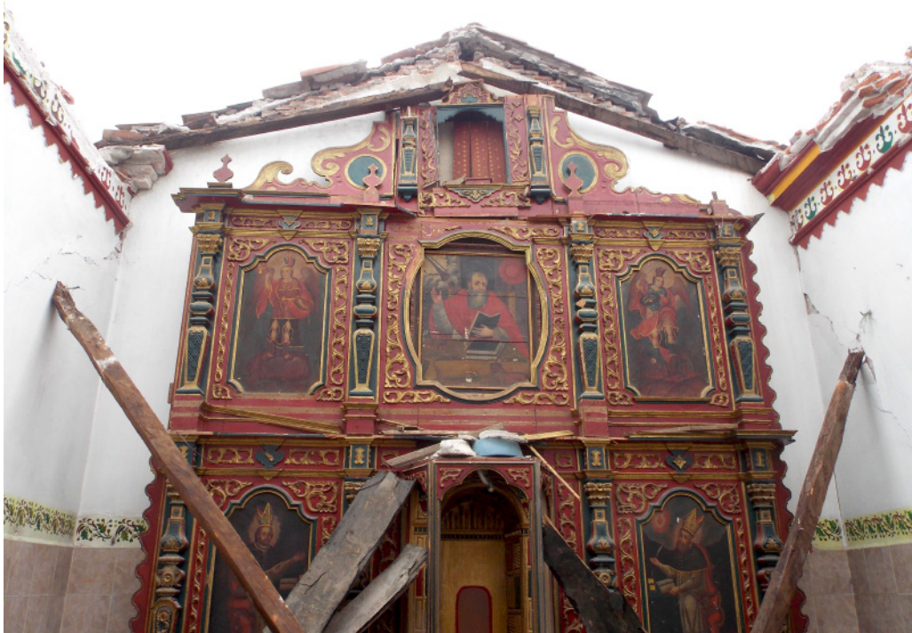
Figura 5. Desplome de cubierta en el templo de San Jerónimo Doctor, barrio de San Jerónimo Santo Domingo Tehuantepec, Oaxaca. Imagen: Salem Ojeda Cabrera ©CINAHO-INAH, 2017.
