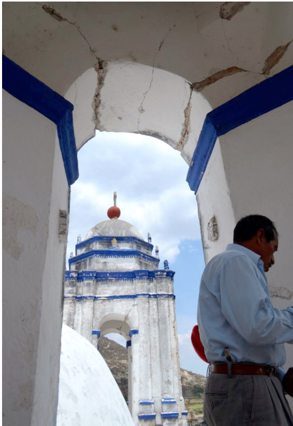
Figura 7. Revisión de daños en campanario, Zimatlán, Oaxaca. Imagen: Salem Ojeda Cabrera ©CINAHO-INAH, 2017.
