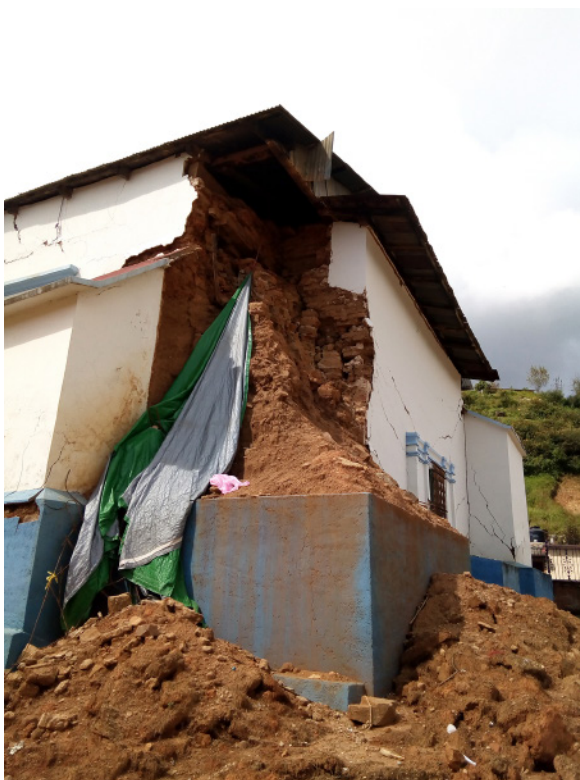
Figura 2. Daños arquitectónicos en la parroquia de la Asunción de María, Santa María Ozolotepec, Miahuatlán, Oaxaca. Imagen: Salem Ojeda Cabrera ©CINAHO-INAH, 2017.
