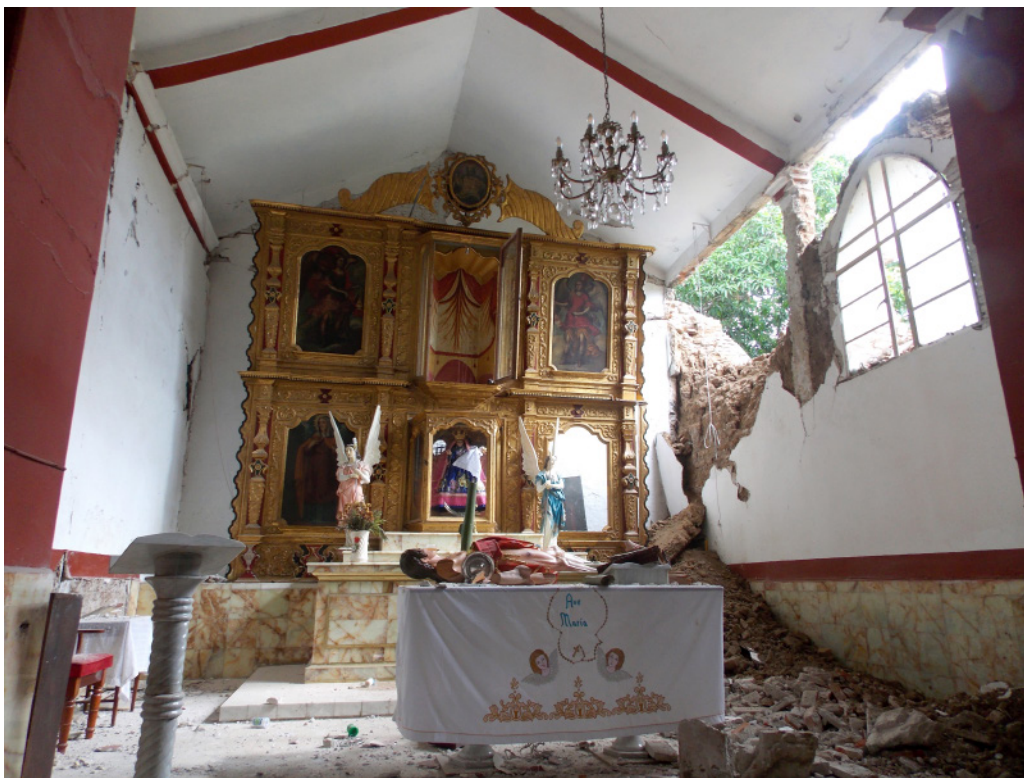
Figura 3. Bienes inmuebles por destino en riesgo de colapso, templo de San Sebastián Santo Domingo Tehuantepec, Oaxaca. Imagen: Salem Ojeda Cabrera ©CINAHO-INAH, 2017.
