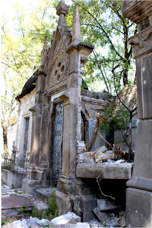
Figura 7. Colapso de muros y bóveda en mausoleo Antonio Lorenz. Imagen: ©Luis Eduardo Gutiérrez García, 2021.
