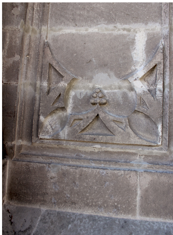
Figura 11. Detalle de rejunteos en fachada de mausoleo Bello. Imagen: ©Luis Eduardo Gutiérrez García, 2021.
