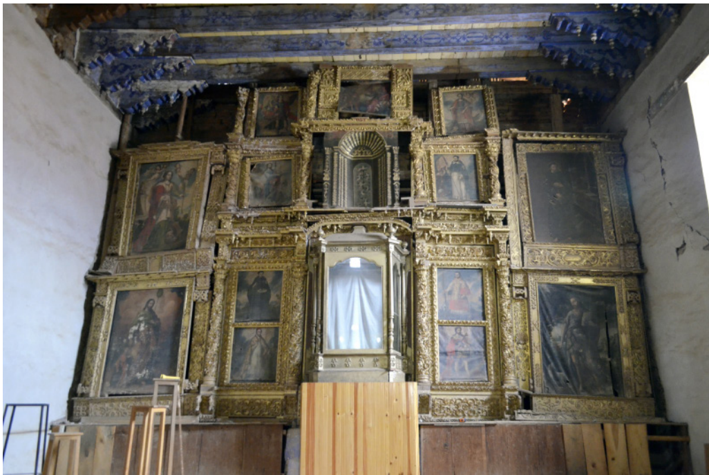
Figura 8. Daños sobre la estructura del retablo principal del templo de la Asunción de María, Santa María Ozolotepec, Miahuatlán, Oaxaca. Imagen: Salem Ojeda Cabrera ©CINAHO-INAH, 2017.
