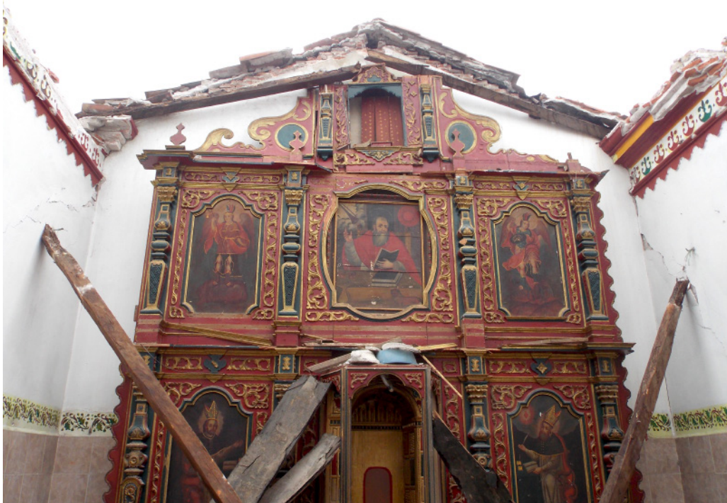
Figura 5. Desplome de cubierta en el templo de San Jerónimo Doctor, barrio de San Jerónimo Santo Domingo Tehuantepec, Oaxaca. Imagen: Salem Ojeda Cabrera ©CINAHO-INAH, 2017.
