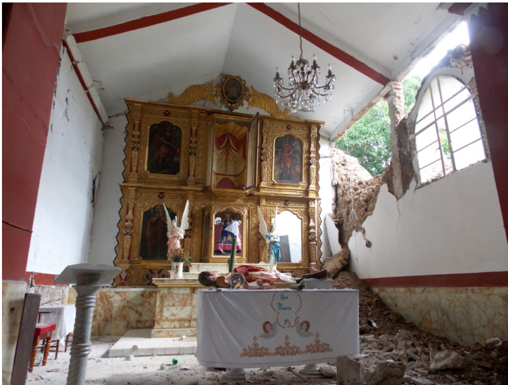
Figura 3. Bienes inmuebles por destino en riesgo de colapso, templo de San Sebastián Santo Domingo Tehuantepec, Oaxaca. Imagen: Salem Ojeda Cabrera ©CINAHO-INAH, 2017.
