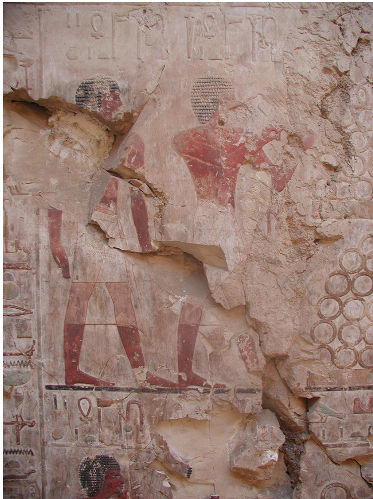
Figura 5. Ejemplo de alteración en la tumba por la presencia de una grieta y subsecuente fractura y desprendimiento del soporte de piedra. Imagen: ©Misión Mexicana en Egipto CNCPC-INAH.
