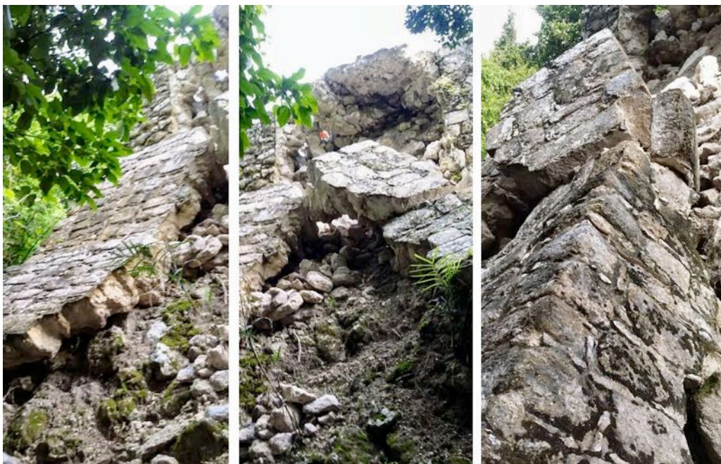
Figura 4. A la izquierda estructura XV, detalle del derrumbe del sector norte, Calakmul, afectado por depresión tropical Eta. Imágenes: Adriana Velázquez, 2020.
