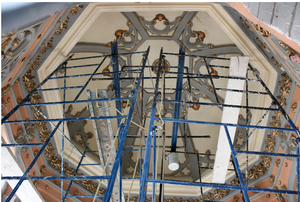
Figura 10. Presencia de andamiaje en interior del mausoleo Bello, con el propósito de efectuar tareas de mantenimiento. Imagen: ©Luis Eduardo Gutiérrez García, 2021.
