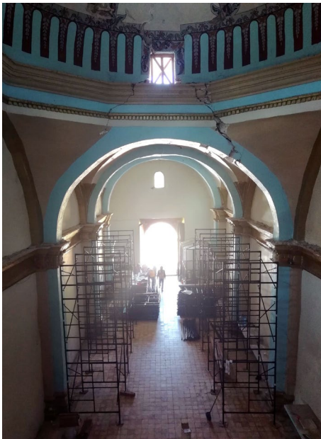
Figura 4. Interior del templo de Santiago Zacango donde se observa parte de la grieta que sube por el tambor. Imagen: Julia Margarita Torres, ©INAH, 2019.
