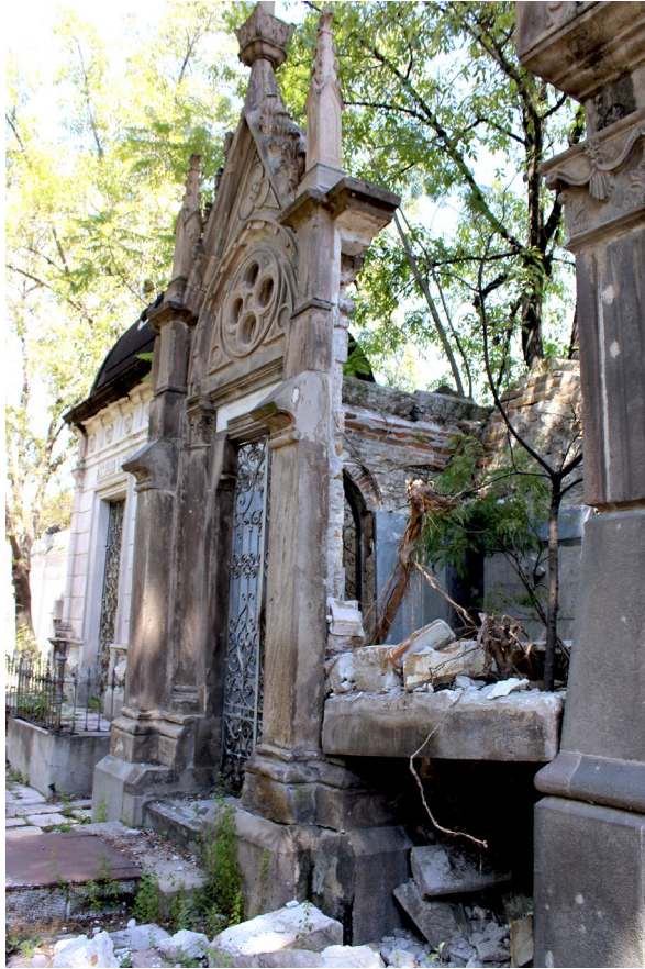
Figura 7. Colapso de muros y bóveda en mausoleo Antonio Lorenz. Imagen: ©Luis Eduardo Gutiérrez García, 2021.
