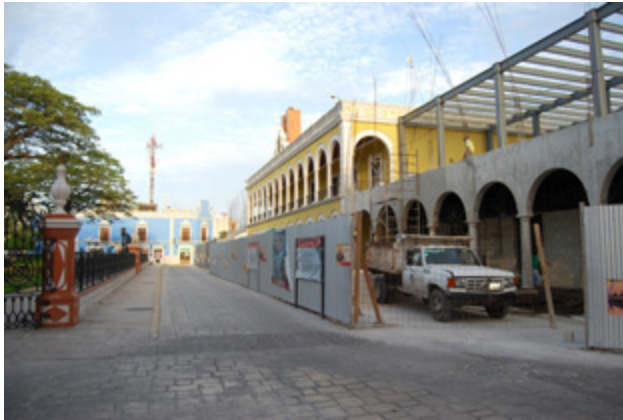
▲ Figura 2. La intervención desarrollada en Campeche, para reconstruir edificios y tramos demolidos de la muralla, implicó gastos innecesarios y afectaciones al entorno natural y cultural. Foto: Luis Fernando Guerrero Baca.
