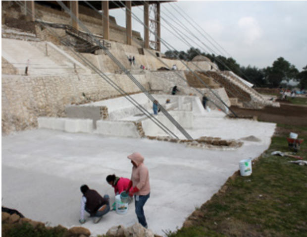
▲ Figura 5. La intervención de reconstrucción parcial de la zona arqueológica de Cacaxtla, Tlaxcala, generó un alto impacto ambiental por la extensión de las obras y la cantidad de cal empleada. Foto: Luis Fernando Guerrero Baca.
