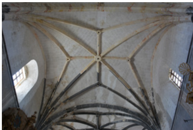
▲ Vista del avance de la intervención de la bóveda del templo | Foto: © Acervo CNCPC-INAH, 2016.
